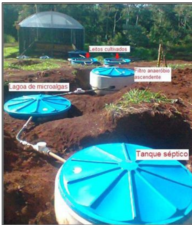
Figura 4 - Estação de Tratamento de Esgoto instalada no Centro de Ciências Agrárias da Universidade Federal de São Carlos.
