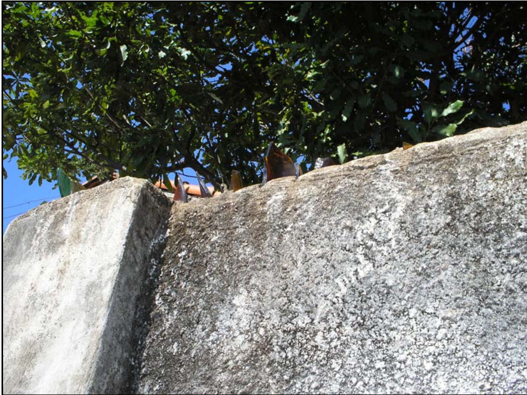
Figura 65 – Cacos de vidro em muros de uma casa no centro da cidade (2005).
