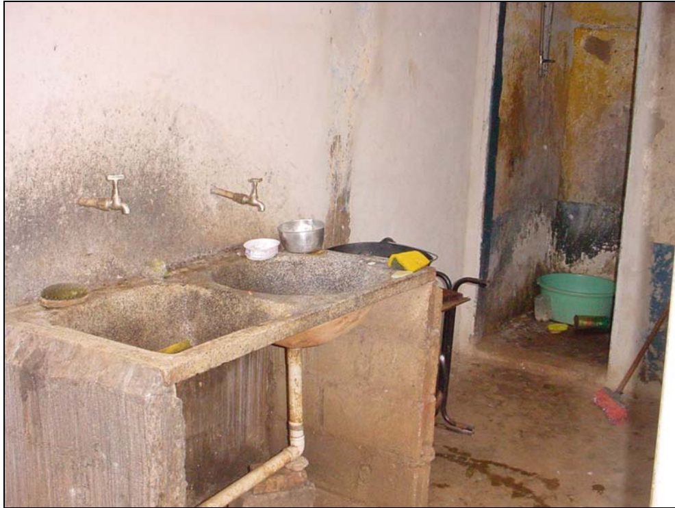
Figura 5 - A pia da “cozinha” e o tanque de lavar roupas ao lado do banheiro.
