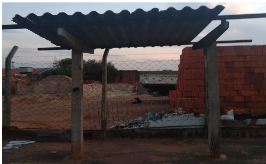
Figura 45: Parada de ônibus antiga com cobertura danificada
