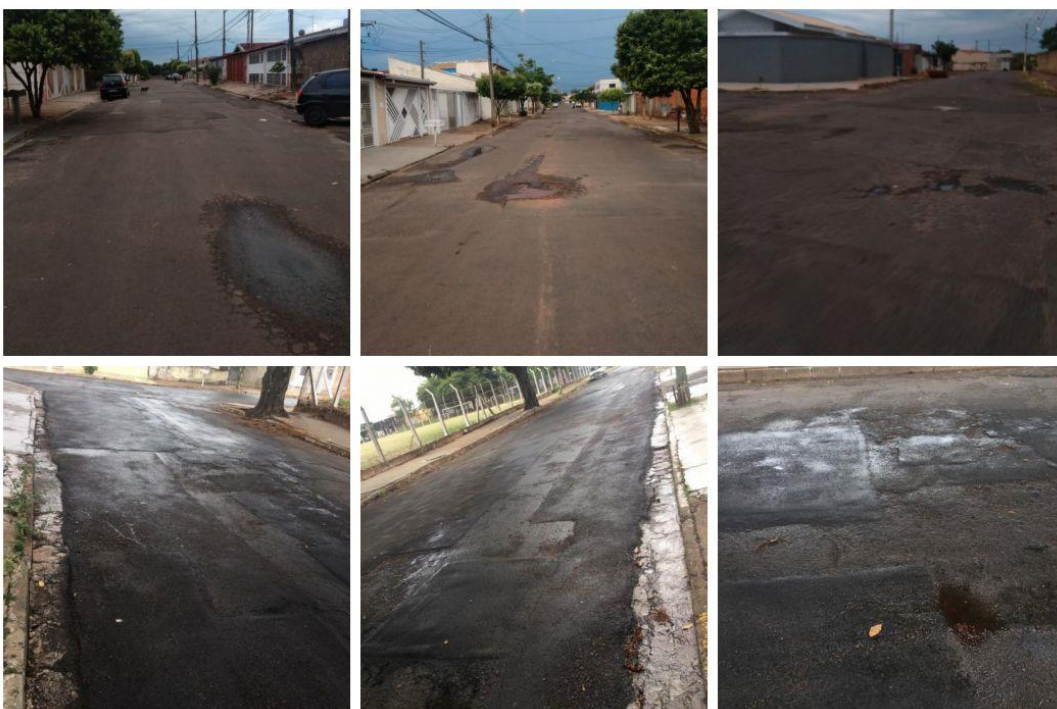
Figura 50: Vias com pavimentação ruim
