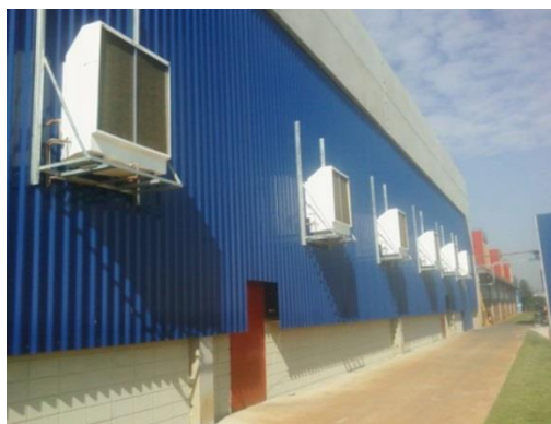
Figura 14: Sistema de ar condicionado.
