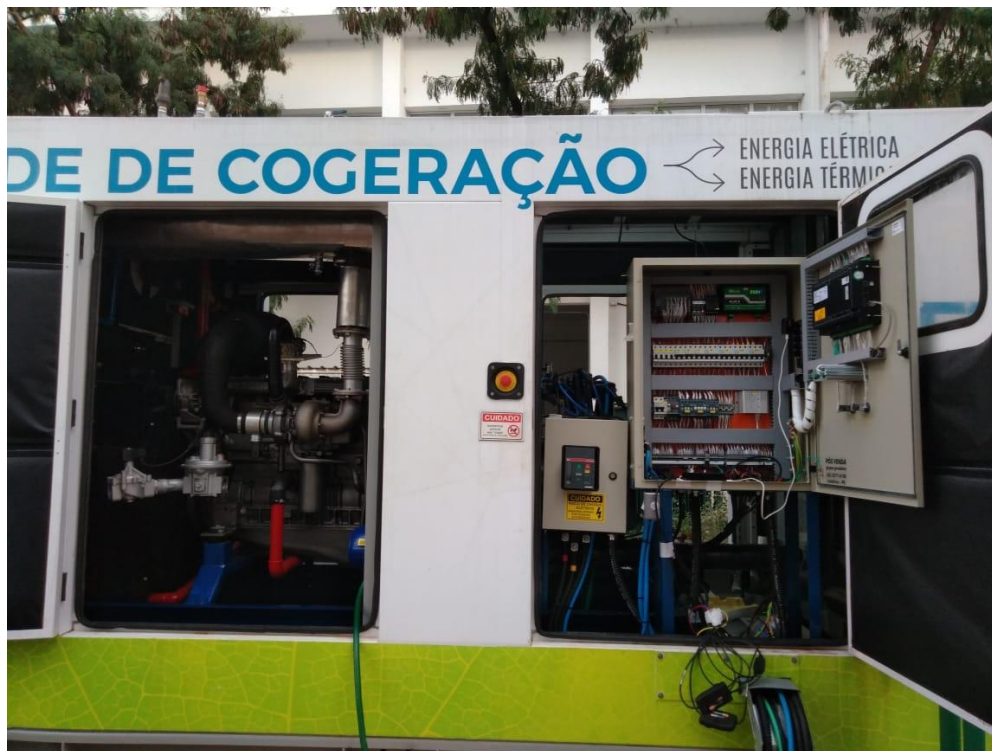
Figura 3.3.5 – Unidade de cogeração de energia
