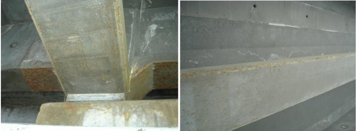
Figura 2.27 – Degradação das fibras na superfície das vigas da ponte OA4 na França
