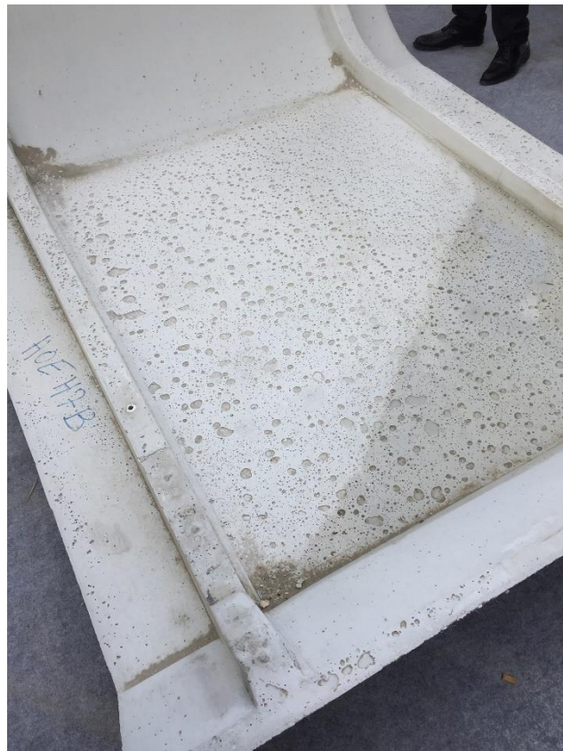
Figura 2.28 – Detalhe de bolhas no lado superior de um dos elementos de cobertura da estação TGV Montpellier, no Sul da França
