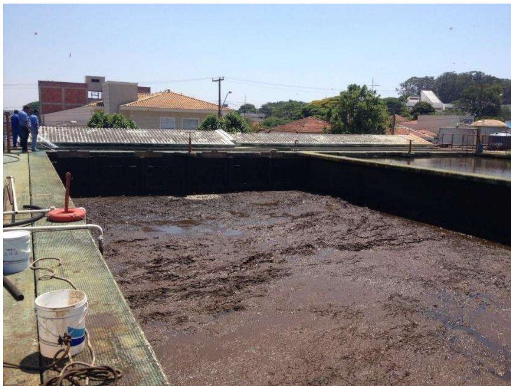
Figura 4.3 - Lodo acumulado no decantador da ETA de São Carlos durante a limpeza para remoção do lodo
