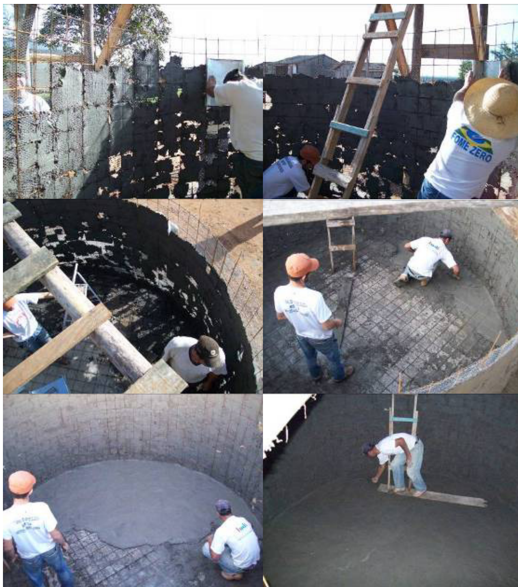
Figura 13 - Etapas do Passo 3 para construção do sistema de captação de água de chuva
