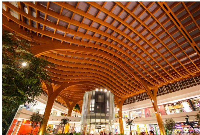
Figura 7 - A estrutura da cobertura da praça de alimentação do Shopping Iguatemi de Fortaleza é feita de madeira laminada colada.
