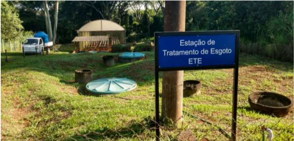
Figura 3. Estação de Tratamento de Esgoto – ETE localizada no CCA/UFSCar campus Araras.
