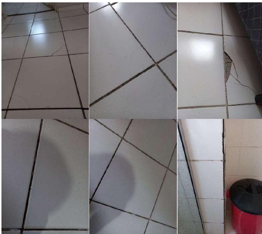
Figura 24: Descolamento de pisos e revestimentos
