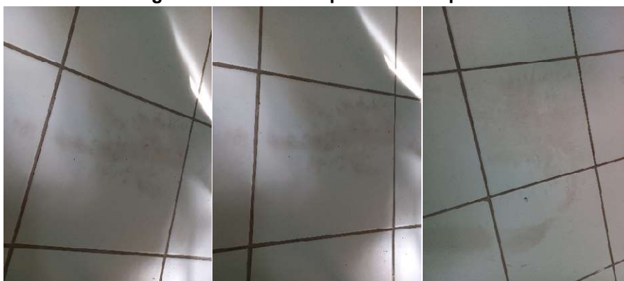
Figura 25: Defeitos superficiais em pisos
