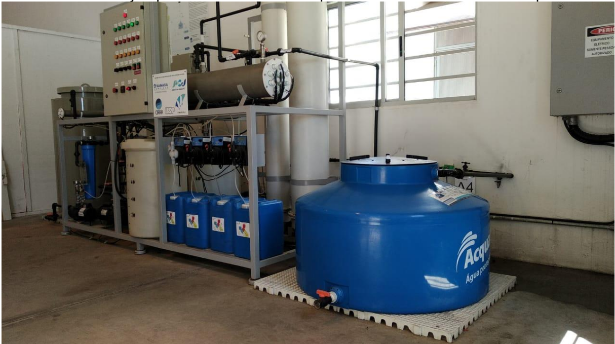
FIGURA 5.2. Estação piloto de tratamento complementar situada na EPAR - Capivari II
