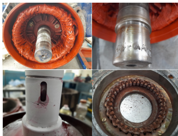
Figura 34 – Condições internas de estator, ponta do eixo e bobina do motoredutor A-1019
