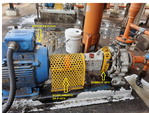
Figura 14 – Conjunto Motor e Bomba 1074
