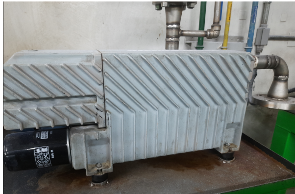
Figura 16 – Conjunto Motor e Bomba 1404
