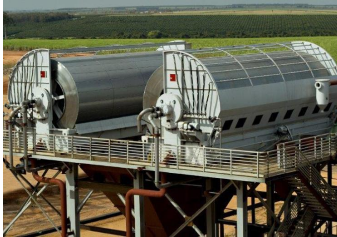
Figura 2.7 - Filtros rotativos instalados em uma unidade industrial
