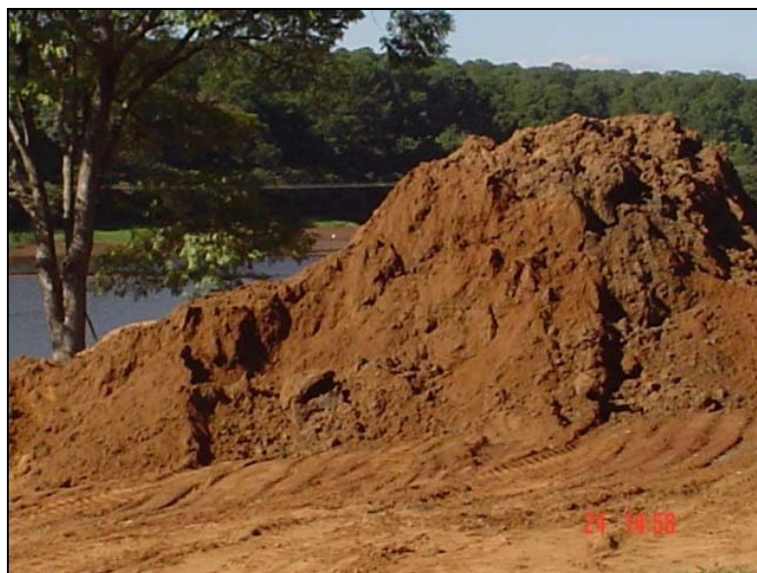
Figura 17. Movimentação de terra para obra de reforma do emissário de esgoto do município de Itirapina no interior da Estação Experimental. Estação Experimental de Itirapina 20/03/2010.
