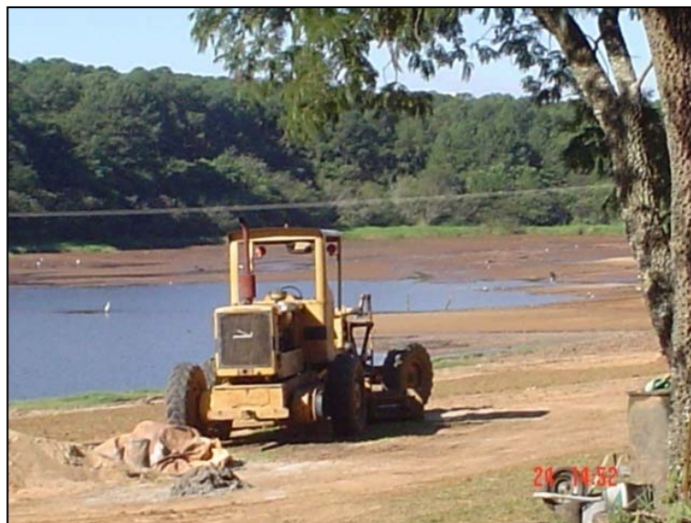
Figura 16. Redução do nível de água da represa da sede das Unidades de Conservação de Itirapina para execução das obras no emissário de esgoto do município. Estação Experimental de Itirapina 20/03/2010
