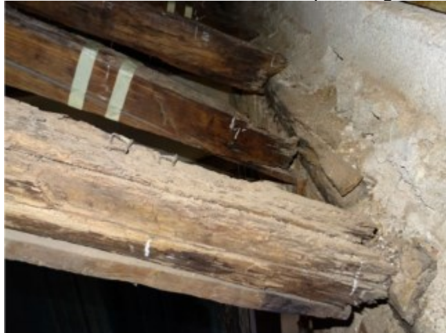
Figura 2 – Elementos de madeira deteriorados por fungos e insetos xilófagos
