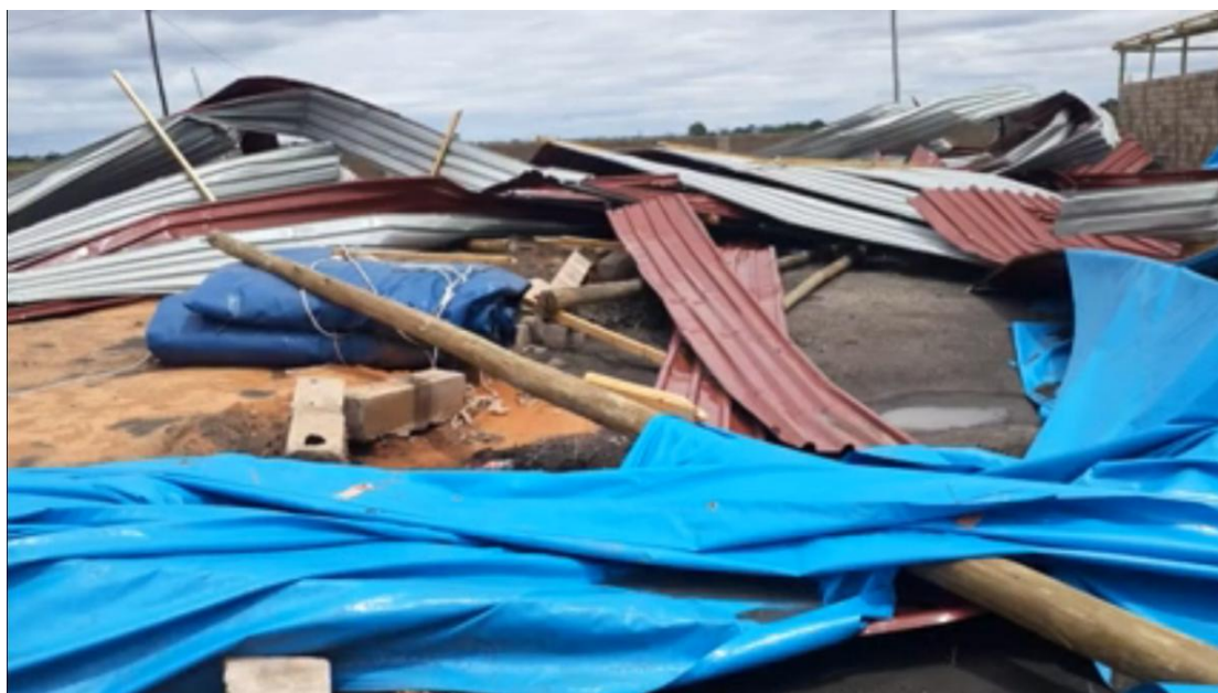
Foto 12: Desabamento do templo. Fonte: Internet .
