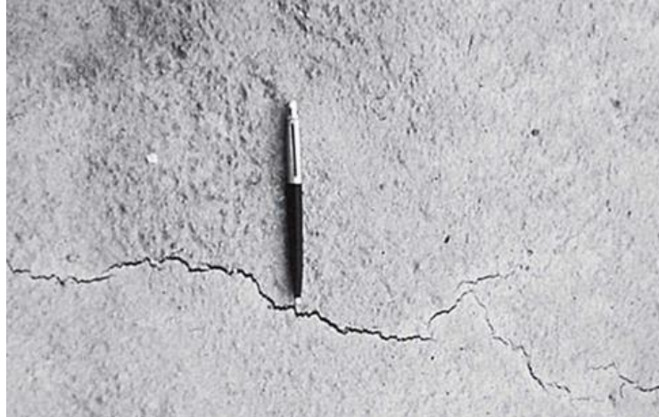
Figura 4.13– Fissura causada pela retração plástica
