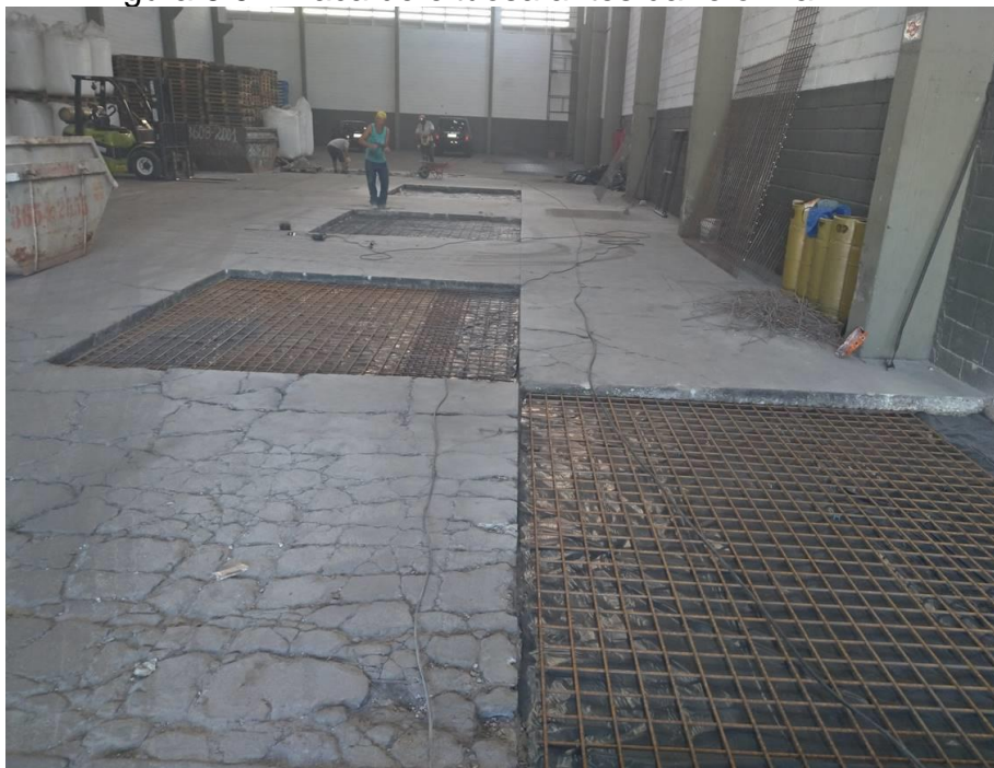
Figura 6.9– Placa defeituosa antes da reforma
