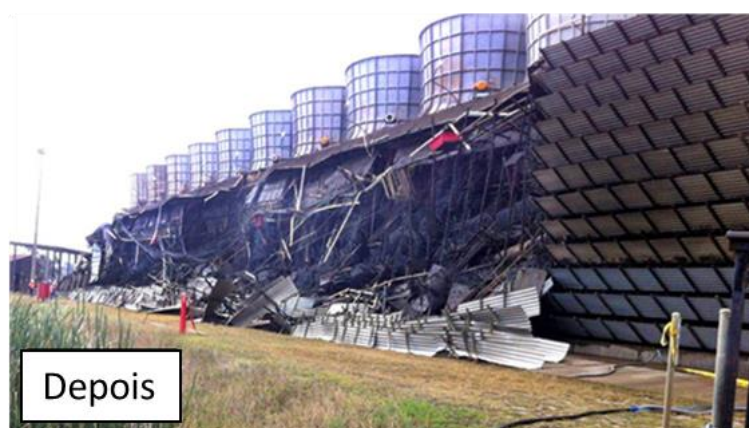
Figura 9 – Situação posterior ao colapso – Torre de resfriamento
