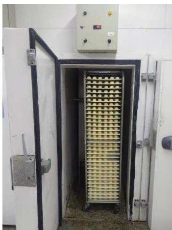
Figura 4: Túnel de congelamento
