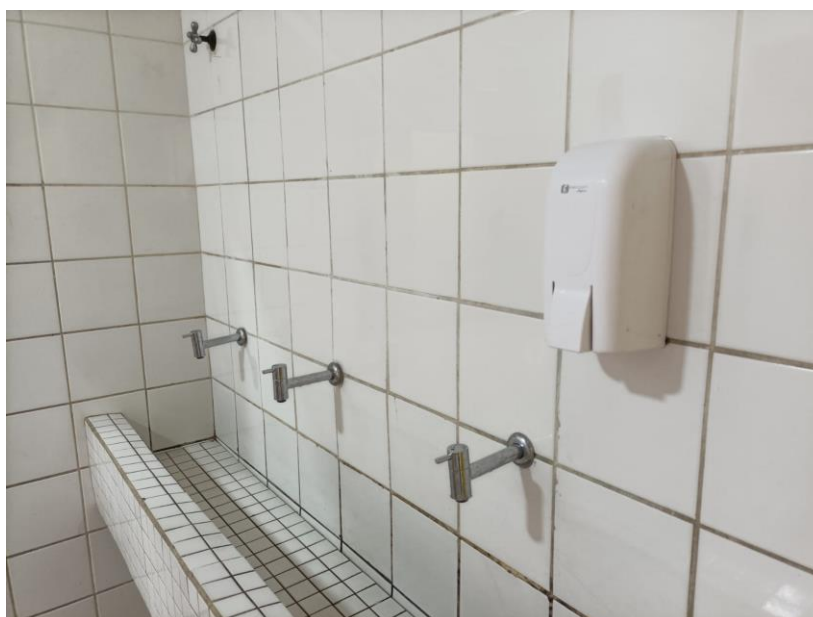
Figura 3 – Pia para lavagem das mãos do banheiro feminino das estudantes.
