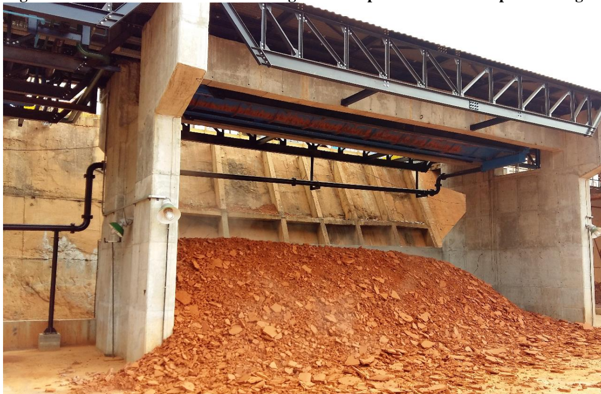
Figura 22 - Resíduo de bauxita na descarga de filtro prensa antes envio para barragem
