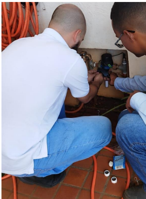
Figura 15 – Instalação de datalogger no sistema Village Flamboyant
