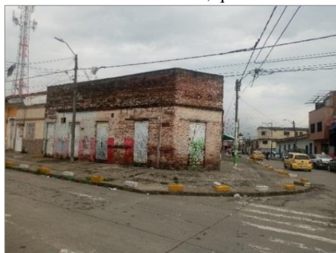
Figura 48 – Prédio em estado de conservação ruim, Carrera 12 com Calle 20, quadra A0322
