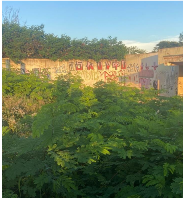
Figura 2: Leucenas invadindo construção abandonada da cidade de Tatuí/SP. Fonte: Autor.
