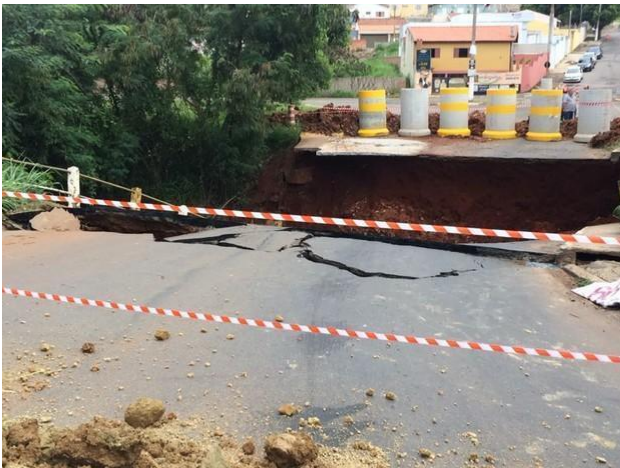
Figura 36. Ponte derrubada pela sobrecarga do Rio Tatuí causada pela impermeabilização do solo e pela alta pluviosidade da época (2017).
