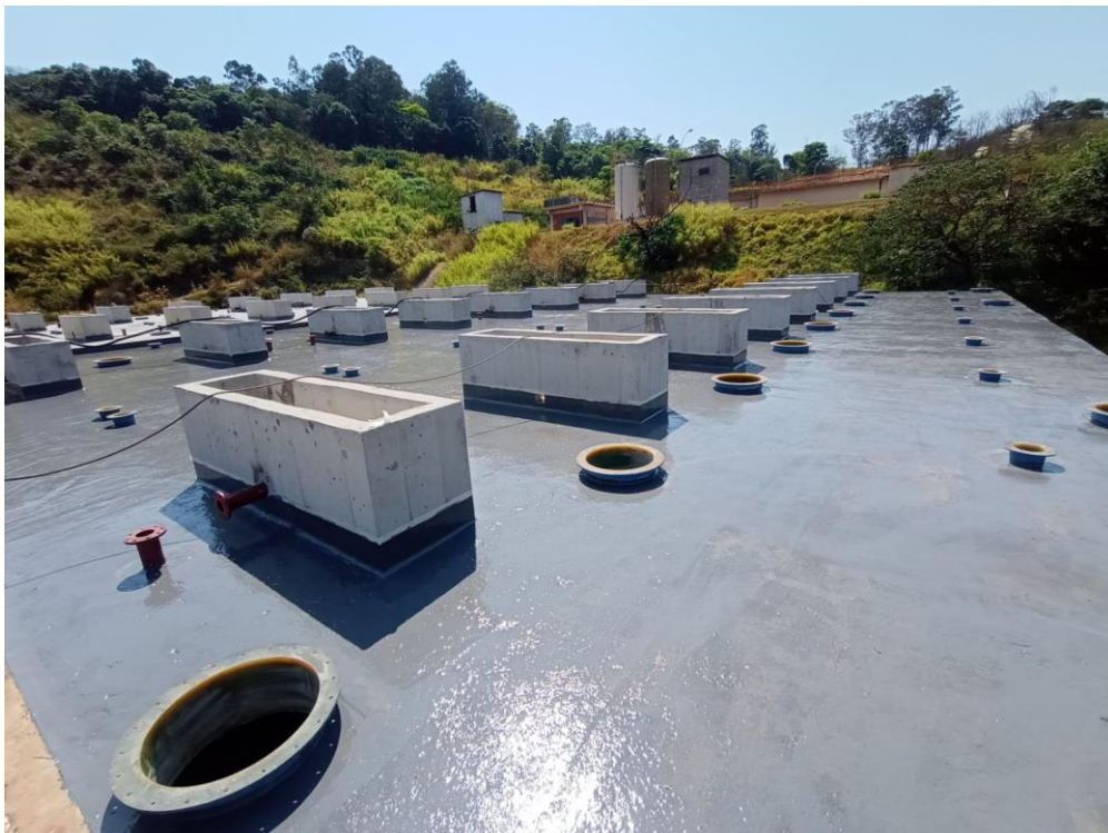
Figura 21: Membrana de Poliuretano com Alta Resistência Química em Estação de Tratamento de Esgoto
