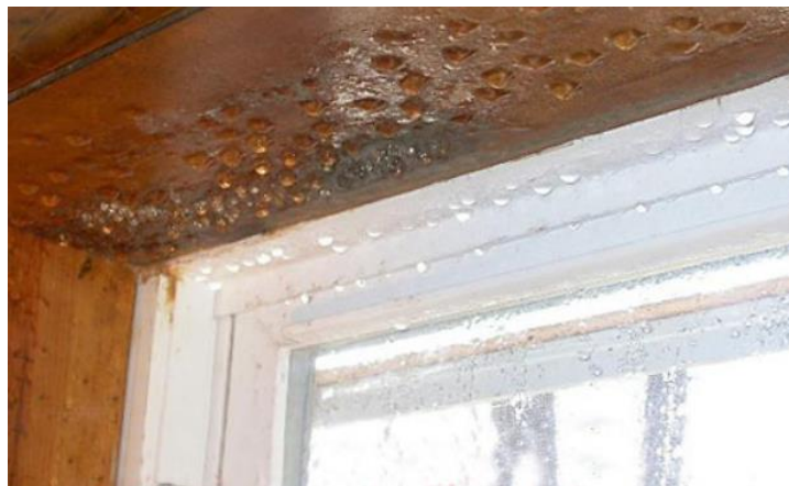
Figura 2.19: Efeito da umidade por condensação [31].
