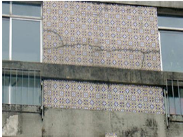
Figura 2.17: Fissuras em fachada decorrentes da umidade por precipitação [29].
