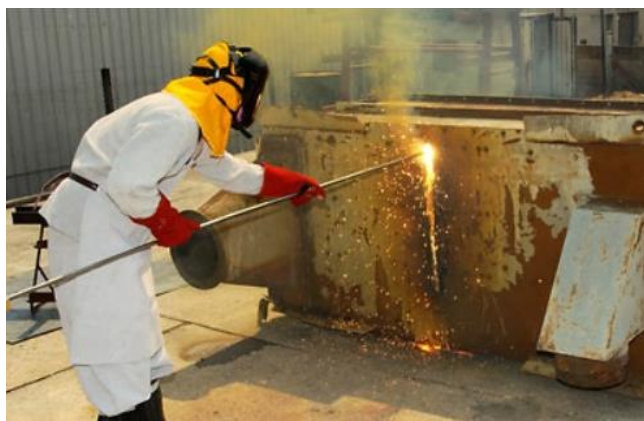
Figura A.7 – Demolição em elemento de concreto por corte com lança térmica
