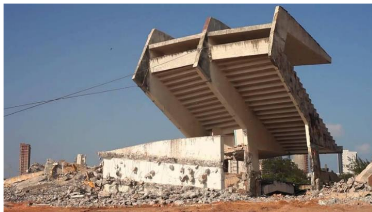
Figura A.4 – Demolição de arquibancada de estádio esportivo por tração de cabos puxadores
