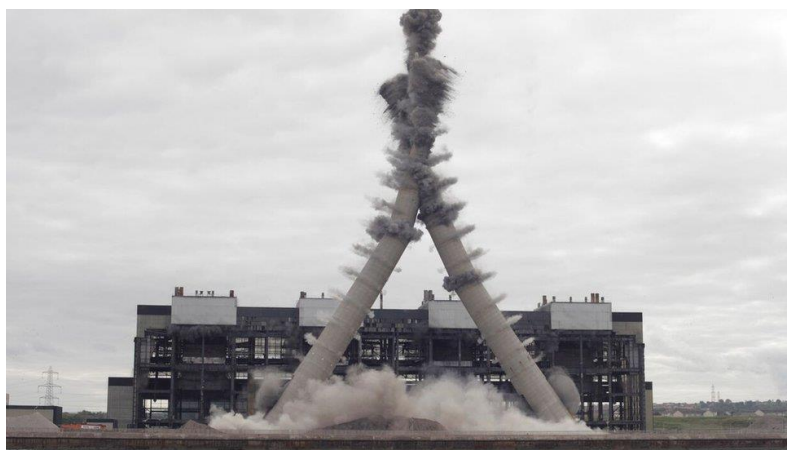
Figura A.6 – Demolição de chaminés da Central Elétrica de Cockenzie por meio de explosivos
