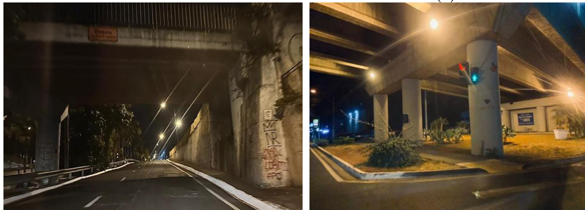
(a) Área sob viaduto classificada como “ruim”
