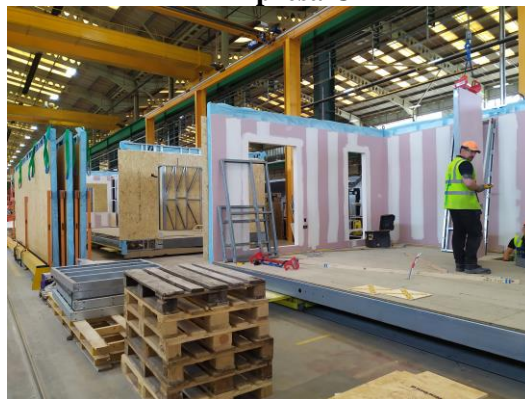
Figura 48 - Materiais/componentes utilizados nos painéis de fechamento externo e nas divisórias – Empresa C
