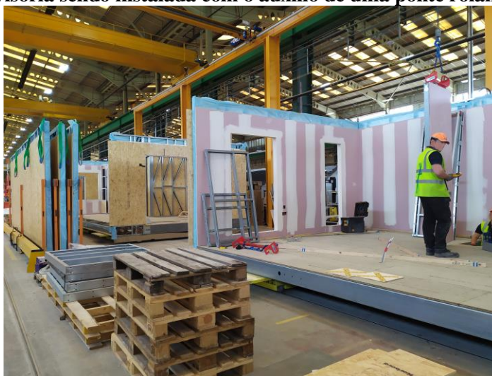
Figura 68 - Divisória sendo instalada com o auxílio de uma ponte rolante – Empresa C
