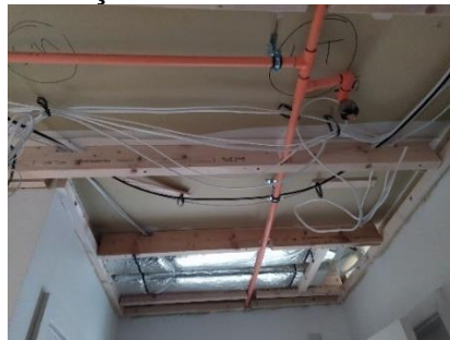
Figura 33 - Instalações elétrica e de incêndio – Empresa A
