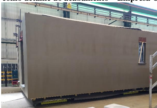
Figura 70 - Acabamento externo do módulo em emboço e tijolos aplicados ao redor das janelas, como detalhe do acabamento – Empresa C
