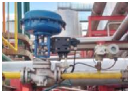
Figura 20 – Válvula real existente na planta
