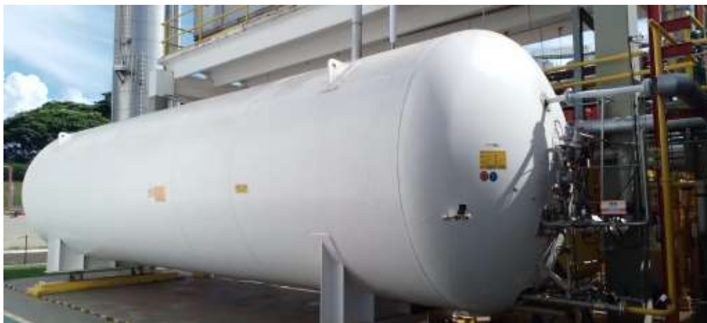
Figura 15 – Tanque criogênico de dióxido de carbono
