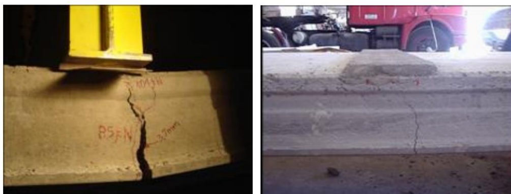
Figura 2.22: Fissura de flexão na face inferior de laje alveolar.
