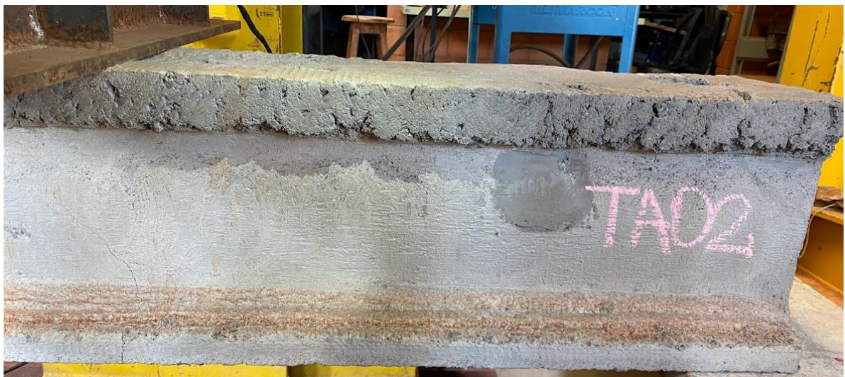
Figura 4.41: Fissura identificada na ruptura da peça TA 02 – Lado A.
