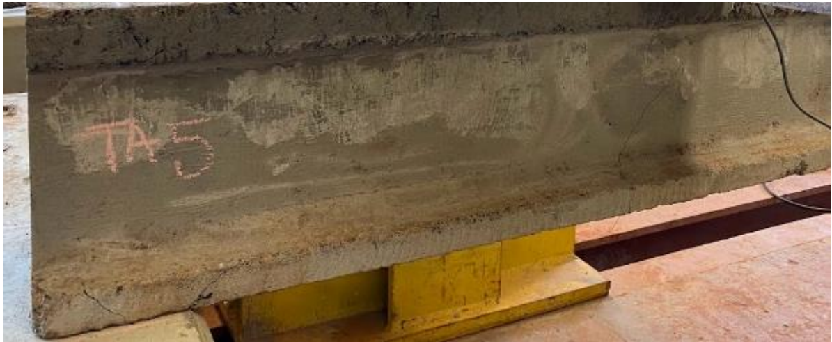
Figura 4.62: Fissura identificada na ruptura da peça TA 05 – Lado B.
