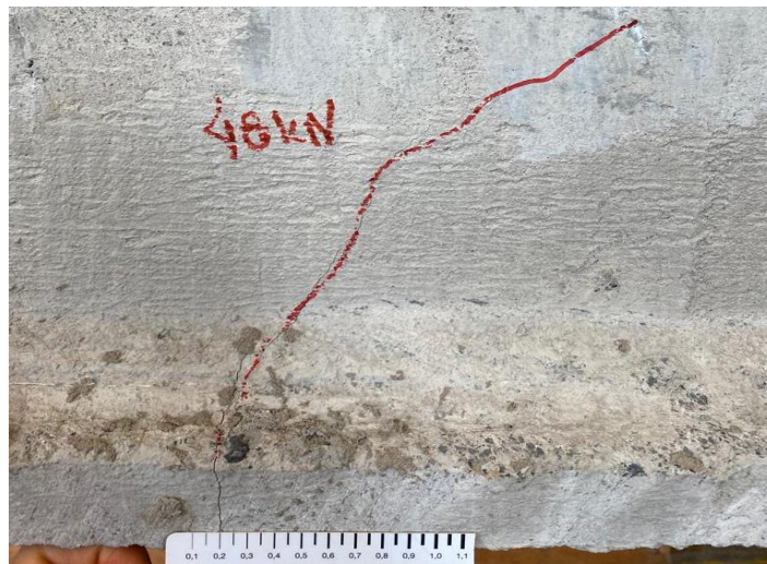
Figura 4.12: Fissura diagonal TA 02.
