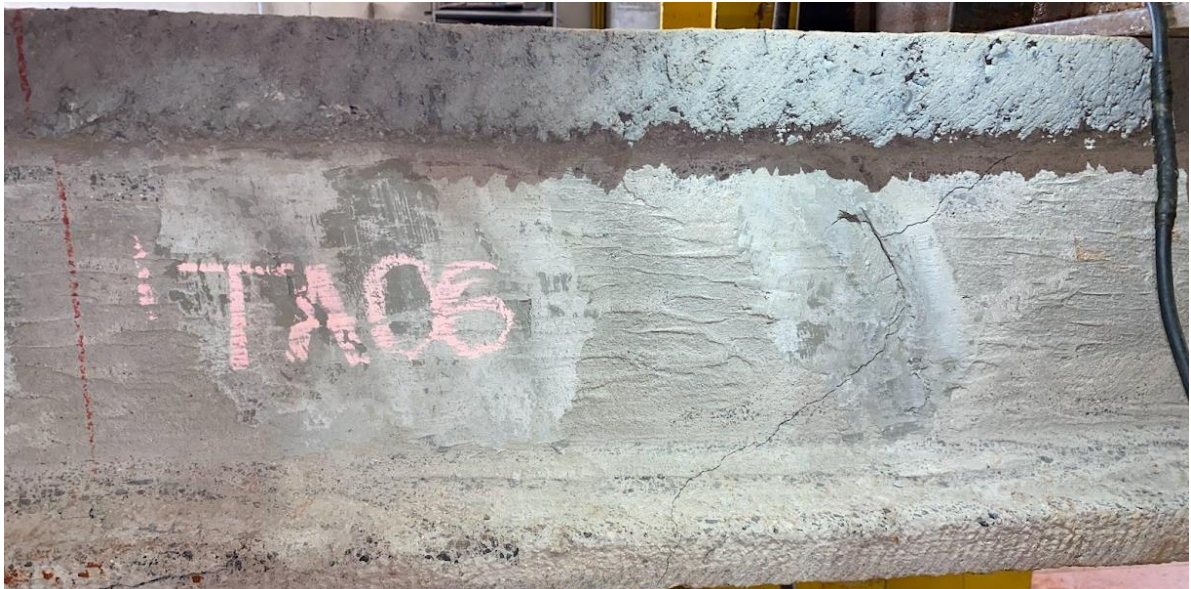
Figura 4.65: Fissura identificada na ruptura da peça TA 06 – Lado A.
