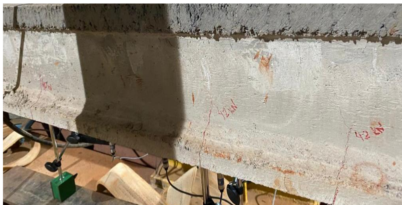
Figura 4.20: Panorama de fissuração da TA 05.
