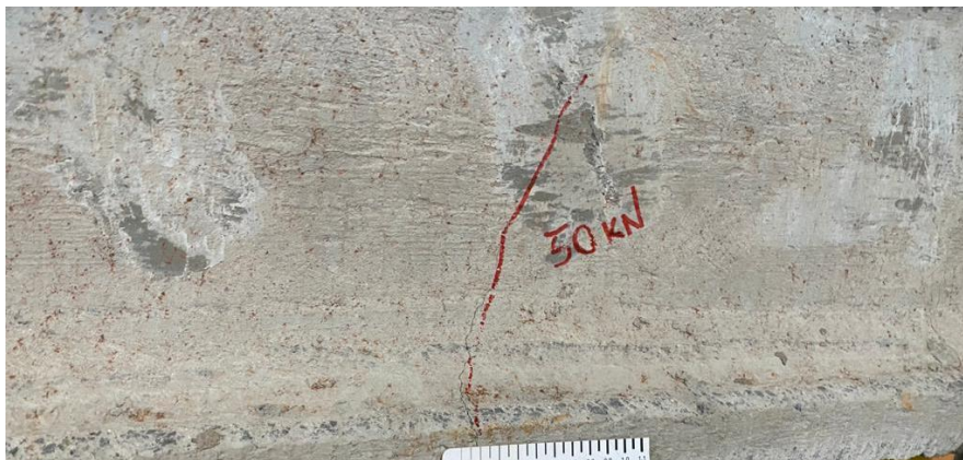
Figura 4.18: Fissura diagonal TA 04.
