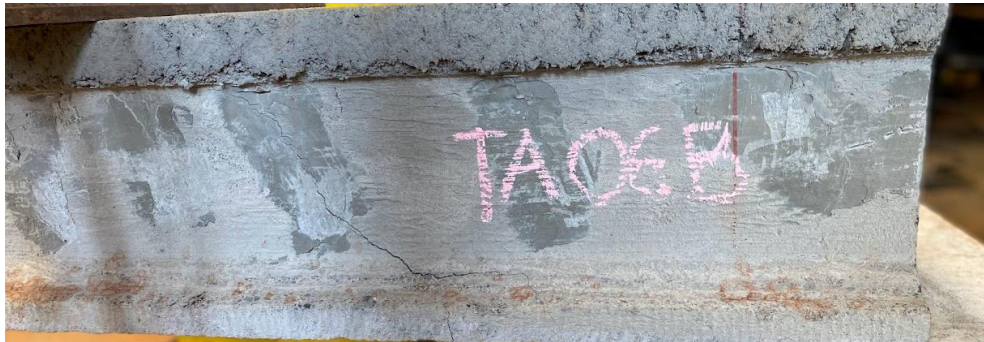
Figura 4.68: Fissura identificada na ruptura da peça TA 06 – Lado B.
