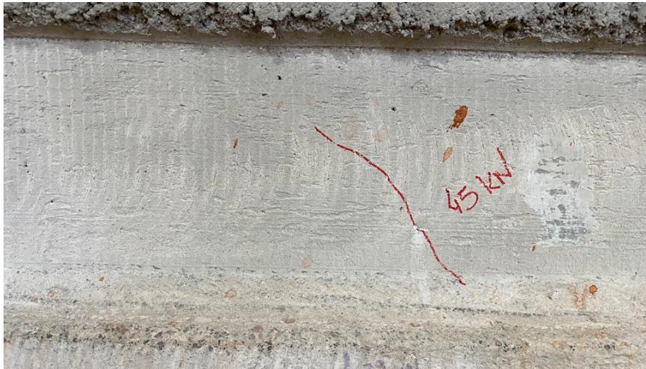
Figura 4.15: Fissura diagonal TA 03.
