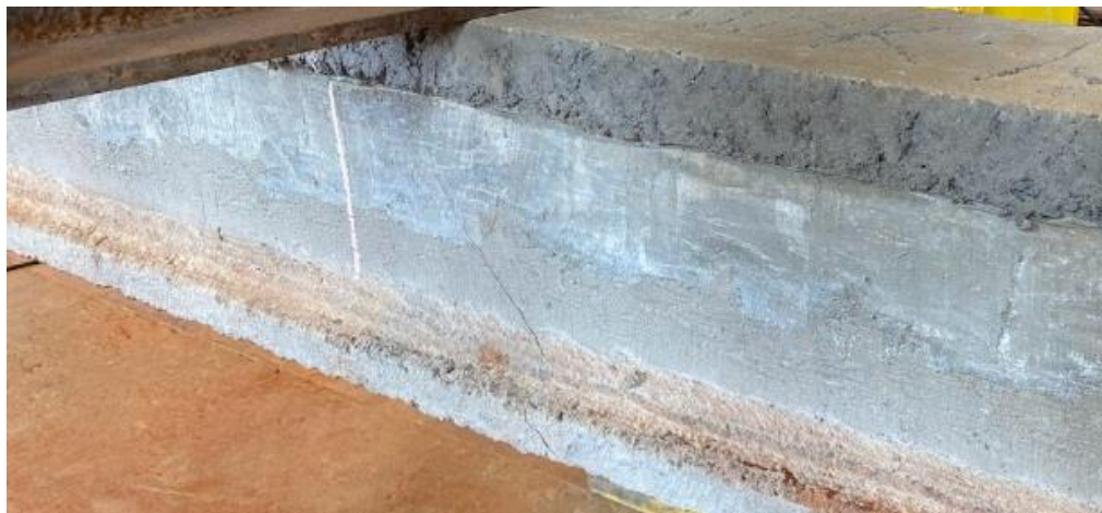
Figura 4.59: Fissura identificada na ruptura da peça TA 05 – Lado A.
