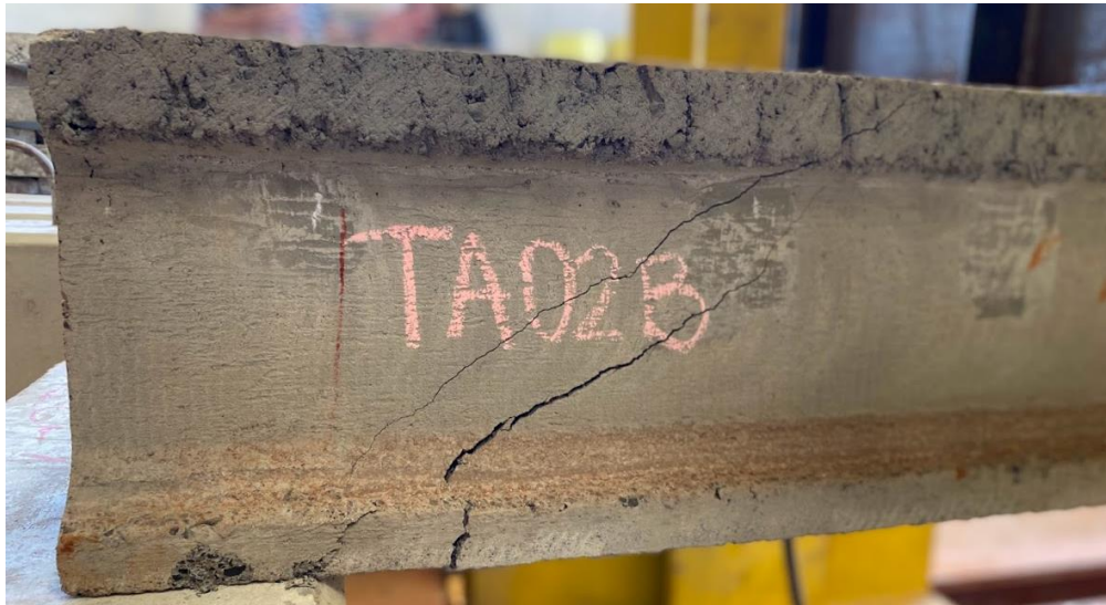
Figura 4.44: Fissura identificada na ruptura da peça TA 02 – Lado B.
