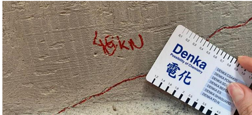
Figura 4.9: Fissura diagonal TA 01.
