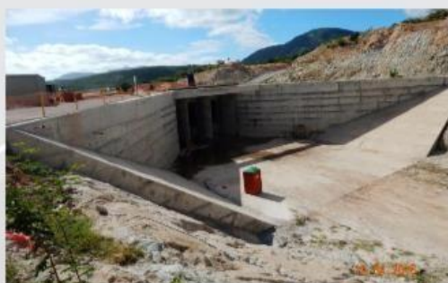
Estrutura de controle Res. Porcos.
