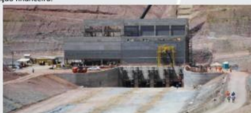
Estação de Bombeamento EBV-3
