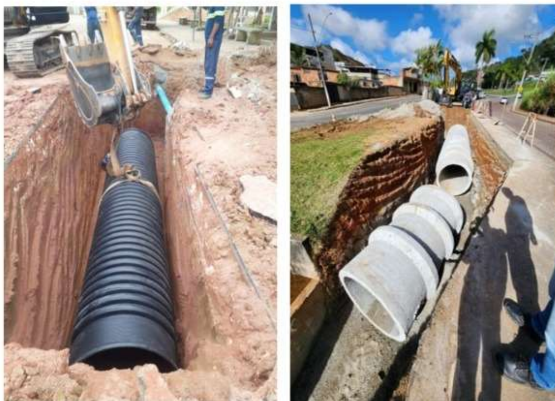
Figura 5. Implantação de rede pluvial em PEAD no bairro Amazônia (a esquerda) e em manilhas de concreto no bairro Salvaterra (a direita).
