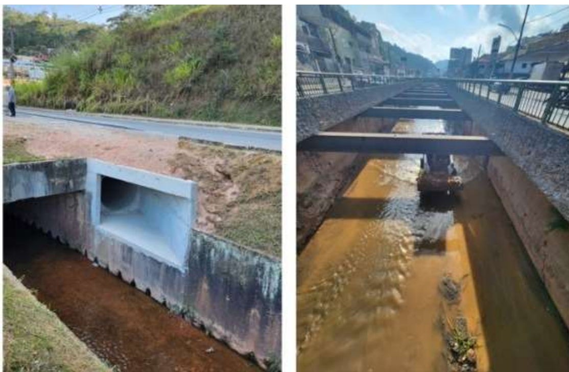
Figura 4. Ala de lançamento de rede de drenagem implantada no bairro Salvaterra (à esquerda) e canalização aberta revestida em concreto no bairro Ipiranga (à direita).
