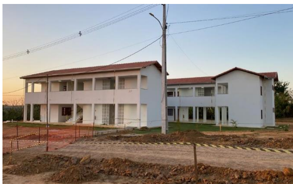
Foto 51: Construção que abriga os novos dormitórios da Escola Popular de Agroecologia e Agrofloresta Egídio Brunetto (acervo pessoal).
