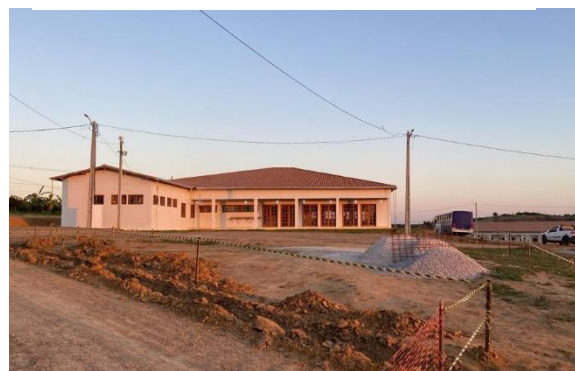
Foto 52: Construção que abriga o novo refeitório da Escola Popular de Agroecologia e Agrofloresta Egídio Brunetto (acervo pessoal).
