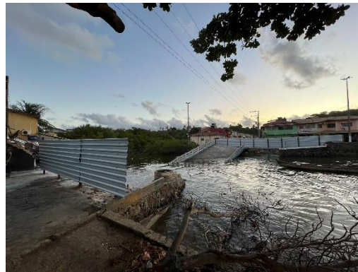
Foto 15: Ponte no Centro, que caiu após a enchente (acervo pessoal).
