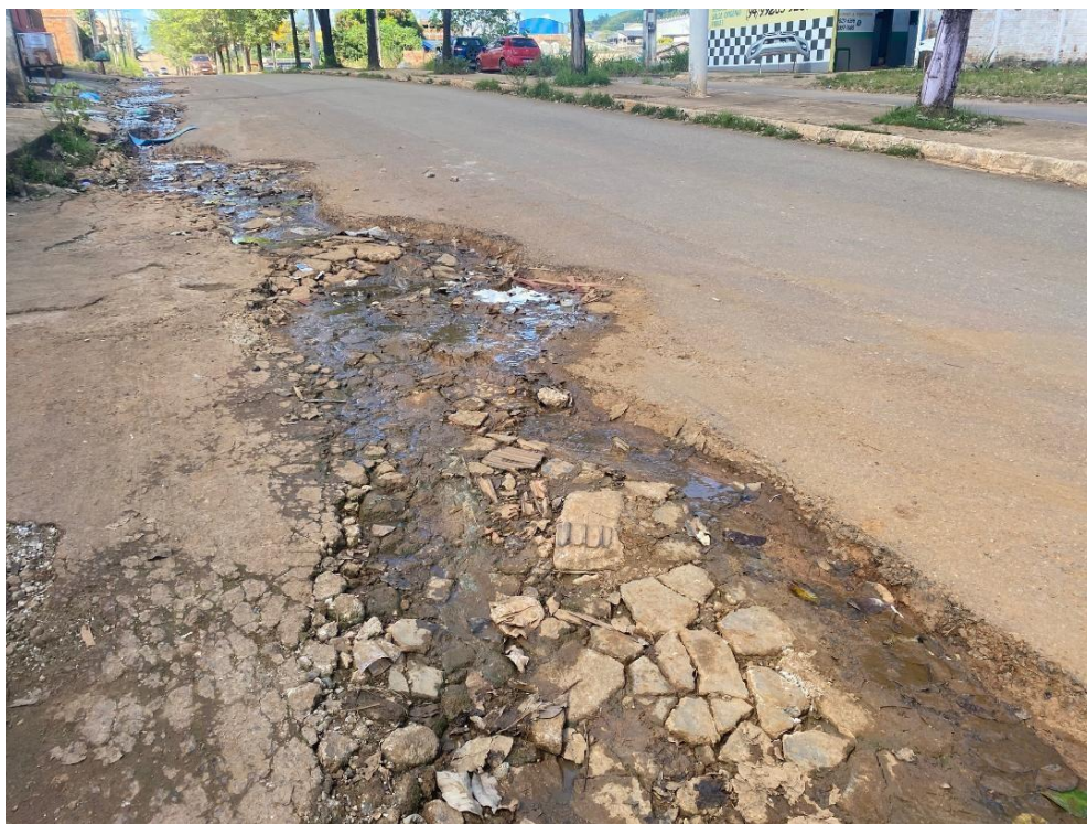
Figura 58. Asfaltamento com a presença de esgotamento sanitário no bairro “Cidade Jardim”
