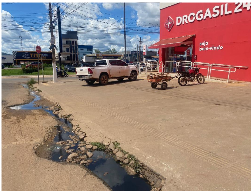
Figura 59. Asfaltamento com a presença de esgotamento sanitário no bairro “Cidade Jardim”
