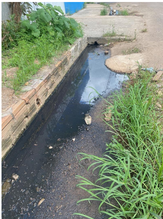
Figura 42. Lançamento de esgoto doméstico em rua do bairro Tropical, Parauapebas-PA
