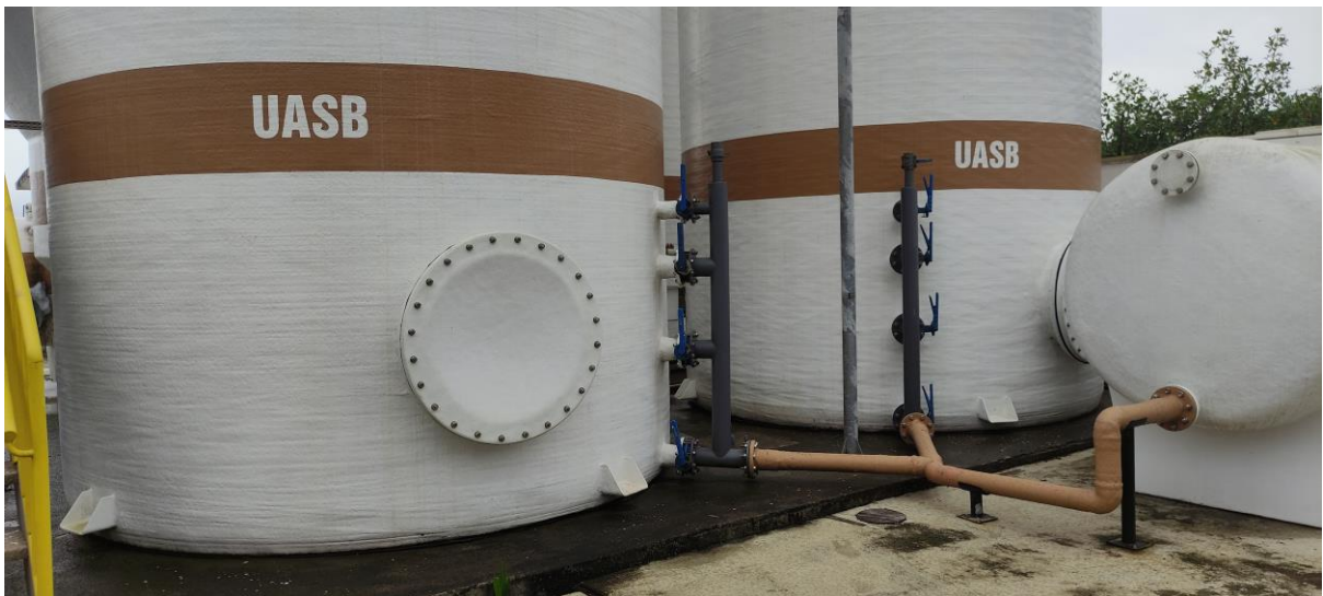
Figura 6 -Tratamento Primário (Fonte: Imagem do autor).
