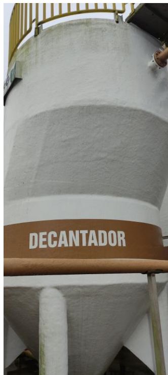
Figura 8 - Tratamento Secundário – Decantador lamelar secundário (Fonte: Imagem do autor).
