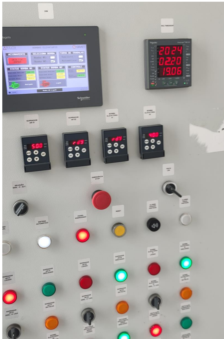
Figura 11 - Painel de automação (Fonte: Imagem do autor).
