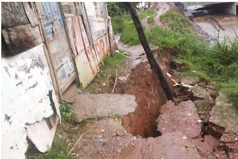
Figura 46: Desbarracamento da margem do cór. Capim Puba. Foto: Defesa Civil Goiás (2002).
