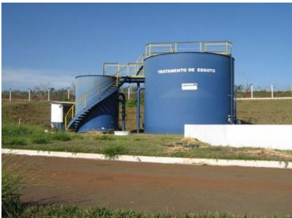
Figura 4 - Foto da estação de tratamento de esgoto de Água Vermelha, São Carlos, SP. Em destaque os biorreatores anaeróbios.
