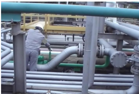
Figura 48 – Acesso inadequado à válvula de W-13
