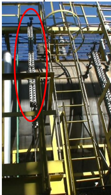
Figura 58 – Medidor do nível do vaso de pressão
