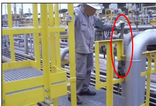
Figura 31 – Cano de aço para movimentação da válvula
