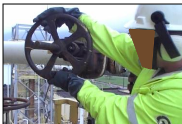
Figura 39 – Operador aplicando força à válvula para abrir
