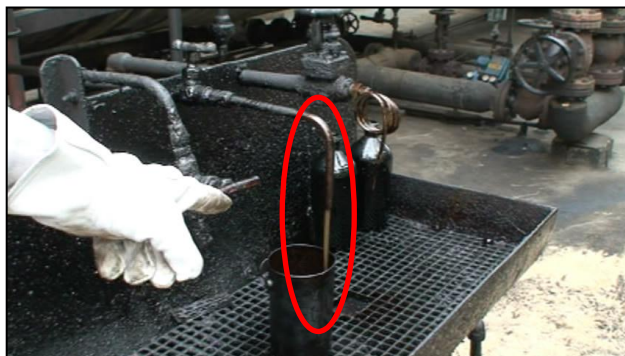
Figura 24 - Detalhe da água do Bico de amostragem, na lateral da Dessalgadora
