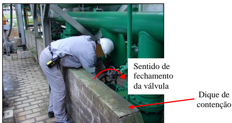
Figura 51 – Dique impedindo a abertura de válvula de W8
