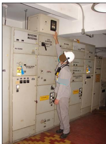
Figura 41 – Painel de visualização em subestação elétrica
