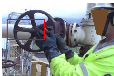
Figura 38 – Detalhe da haste móvel da válvula
