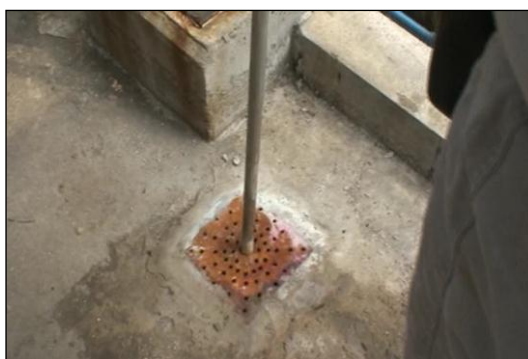
Figura 45 – Tampa em ralo na Unidade C de Destilação Atmosférica (UC)
