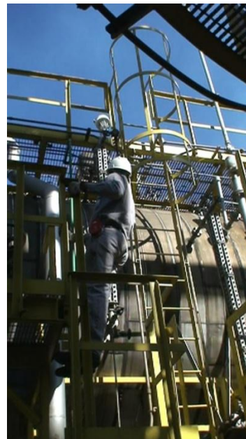
Figura 59 – Operador fazendo a leitura do Medidor
