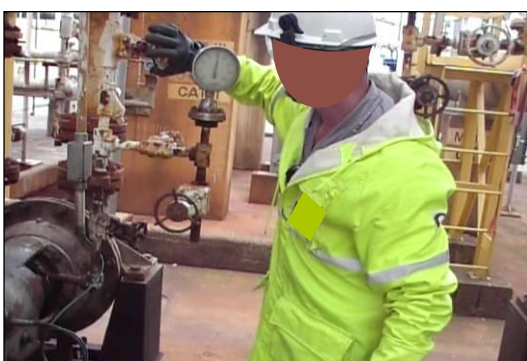
Figura 34 – Verificação do manômetro da bomba de HF
