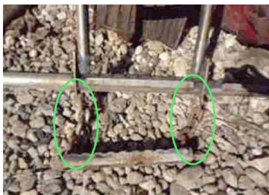
Figura 94. Correntes no degrau de acesso.
