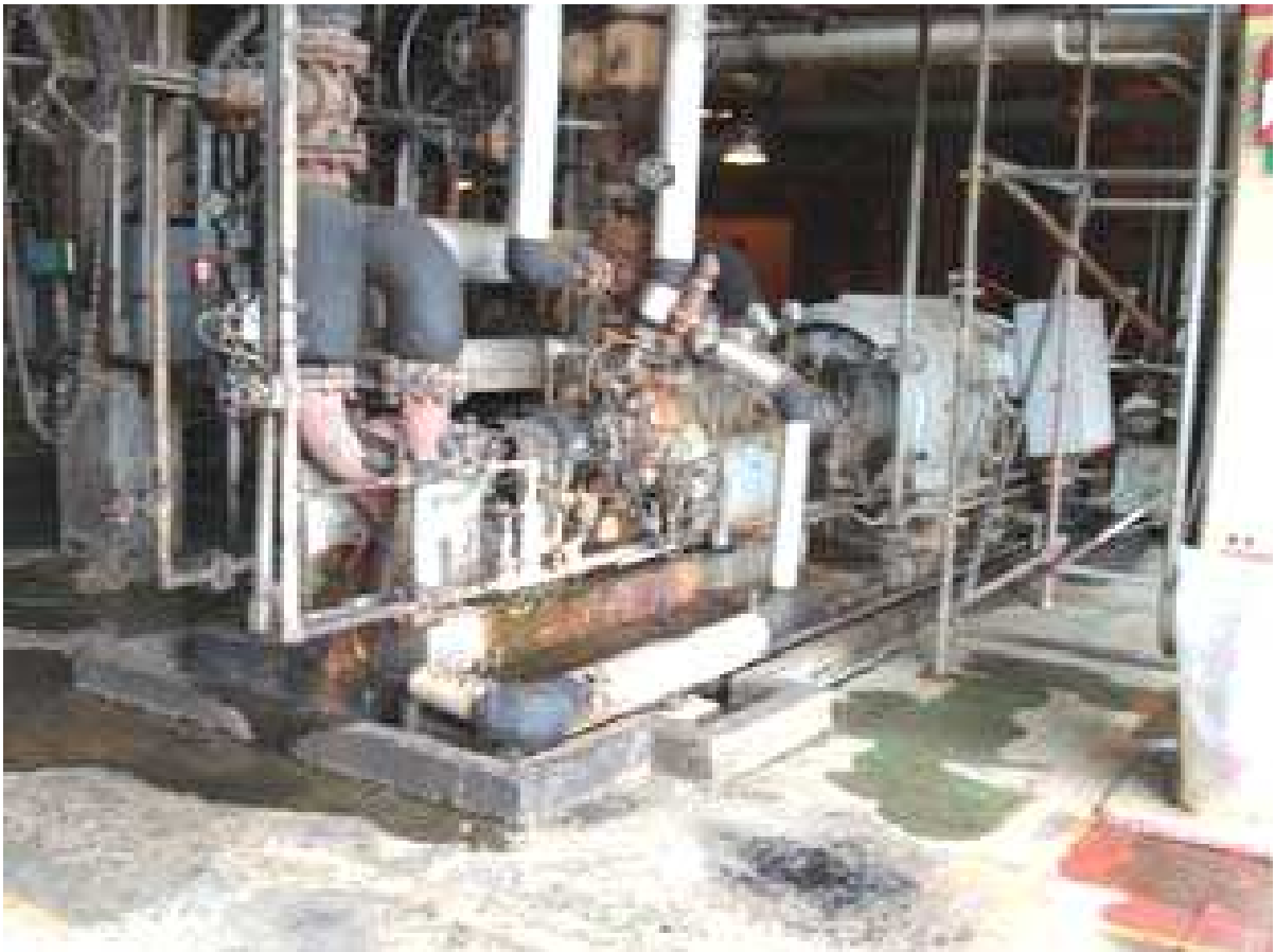
Figura 7: Turbo bomba na área industrial.
