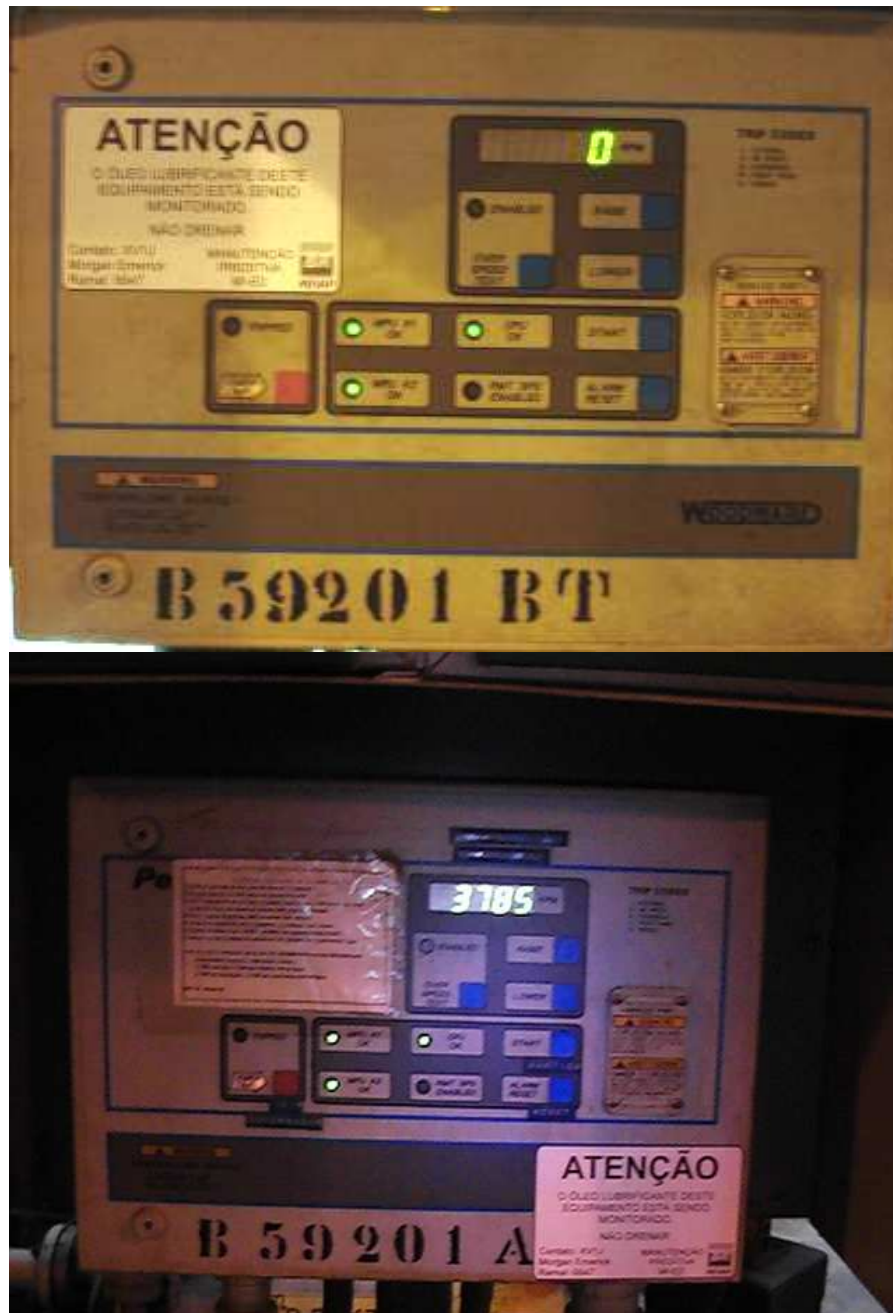
Figura 27- Iluminação noturna sobre o painel da turbo bomba
