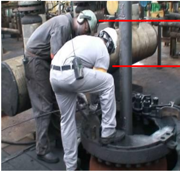
Figura 17 - Fechamento do reator
