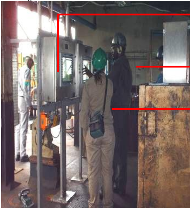
Figura 14 - Painel eletrônico de controle
