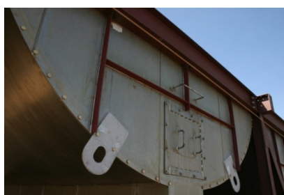
Figura 2: Foto do captador de caldo instalado na usina
