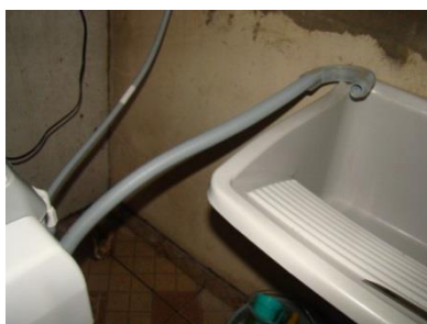
Figura 21 – Lavadora deslocada para frente do tanque.
