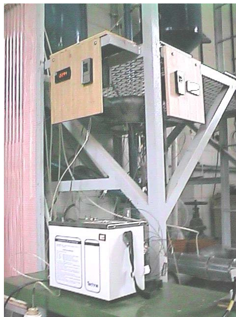
Figura 3.10 – Ilustração do painel com a chave seletora, milivoltímetro e o bloco de aferição dos termopares.
