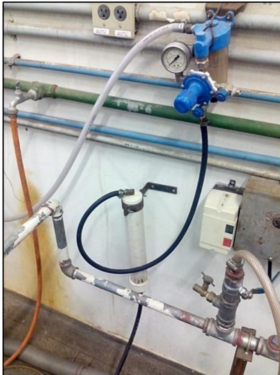
Figura 3.2. Linha de ar secundário. Filtro de linha e secador de ar a base de sílica.
