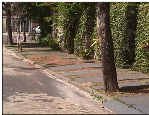
Figura 4.10: Calçada deteriorada devido ao uso.
