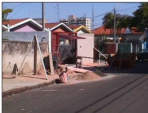
Figura 4.18: Obras sobre as calçadas, obstruindo a área destinada à circulação.
