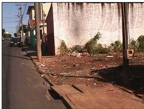
Figura 4.9: Calçada em condições precárias de manutenção.
