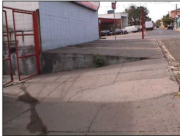
Figura 4.12: Desnível ao longo da calçada.
