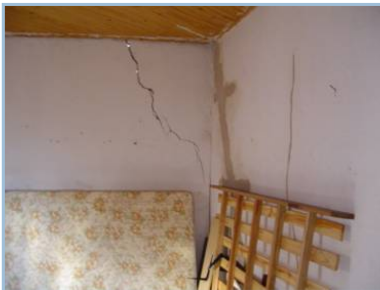
Figura 77 - Comprometimento das Edificações Foto: Olaia, F.B. (2004).
