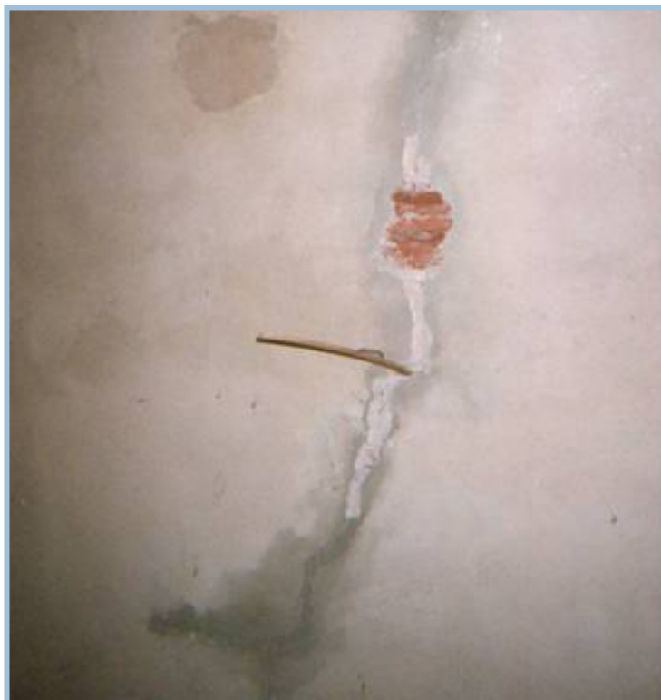
Figura 78 - Falência Estrutural Foto: Dias, B. P (2004).
