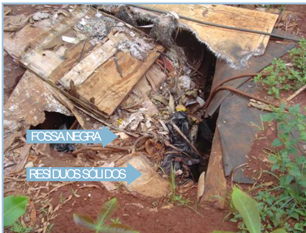
Figura 108 - Fossa Negra coberta com Resíduos Sólidos Foto: Olaia, F. B. (2005)
