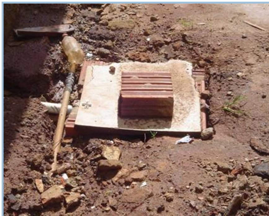
Figura 97 - Tubulações de abastecimento de água Foto: Olaia, F. B. (2005)
