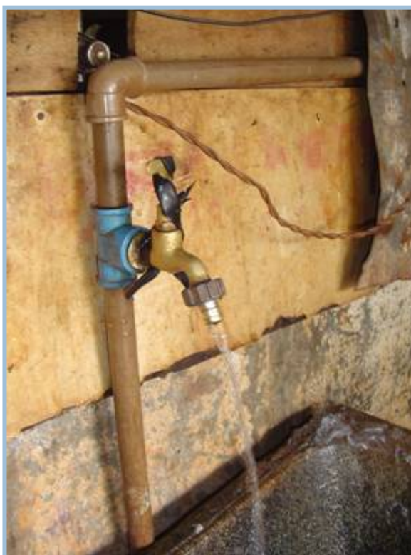
Figura 96 - Desperdício de Agua Foto: Olaia, F. B. (2005)
