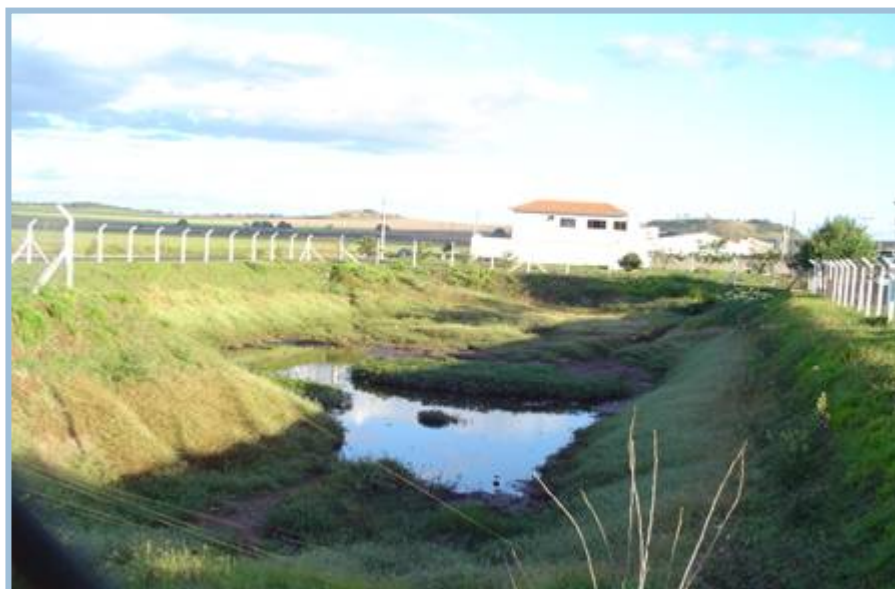
Figura 72 - Bacia de Contenção- Vazamento de Esgoto Foto: Olaia, F.B. (2004).
