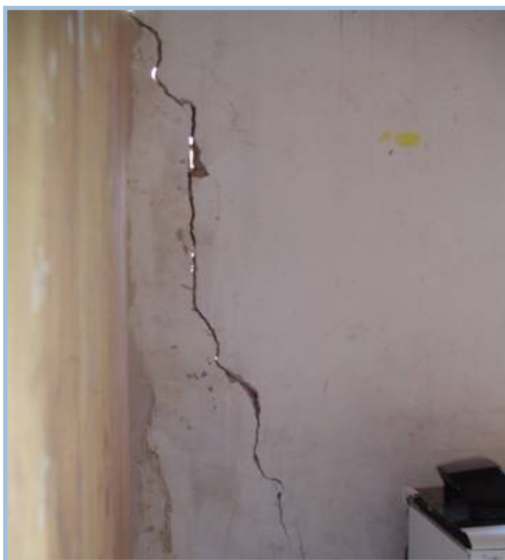
Figura 79 - Edificação Condenada Foto: Olaia, F.B. (2004).
