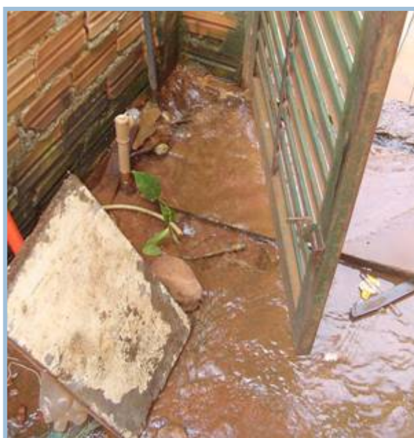
Figura 98 - Vazamento na tubulação Foto: Olaia, F. B. (2005)
