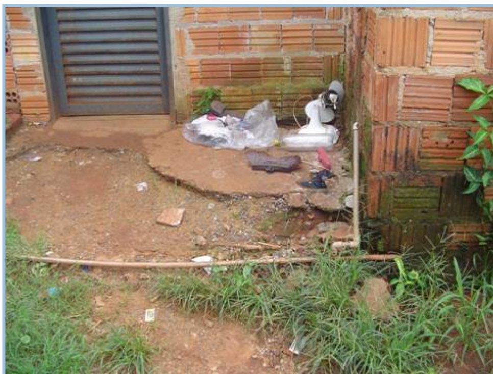
Figura 99 - Tubulação de água Foto: Olaia, F. B. (2005)
