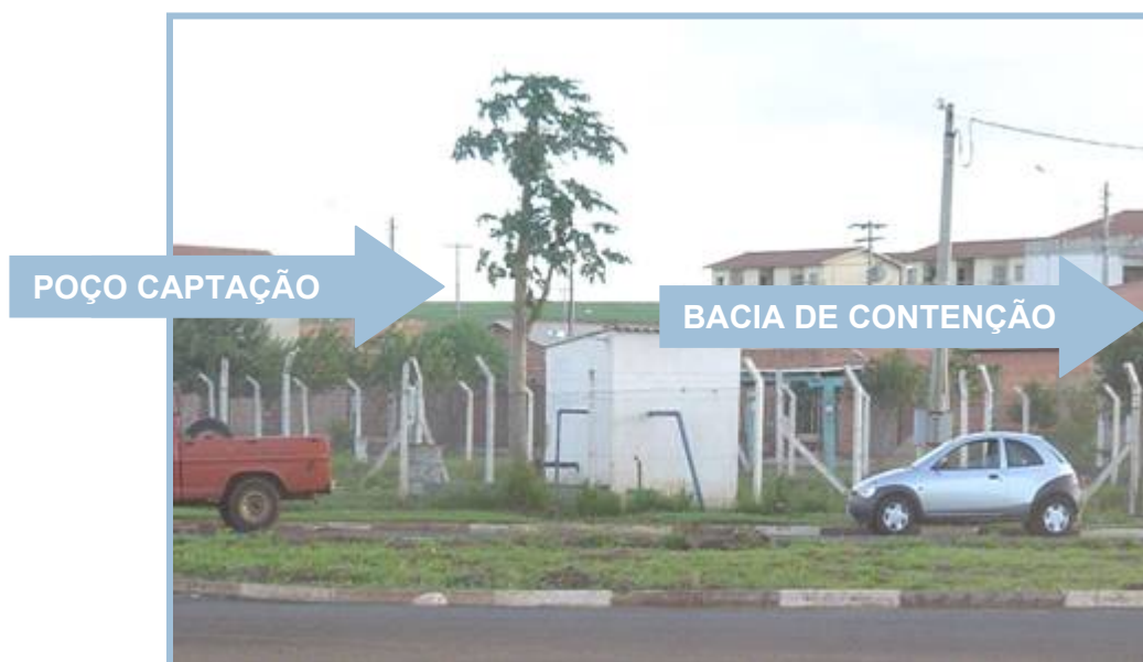
Figura 73 - Bacia de Contenção e Poço captação para abastecimento Foto: Olaia, F.B. (2004).
